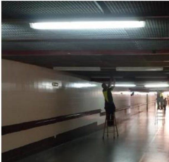
Imagen proceso de instalación LED a mediados de 2019 en HCUVA
